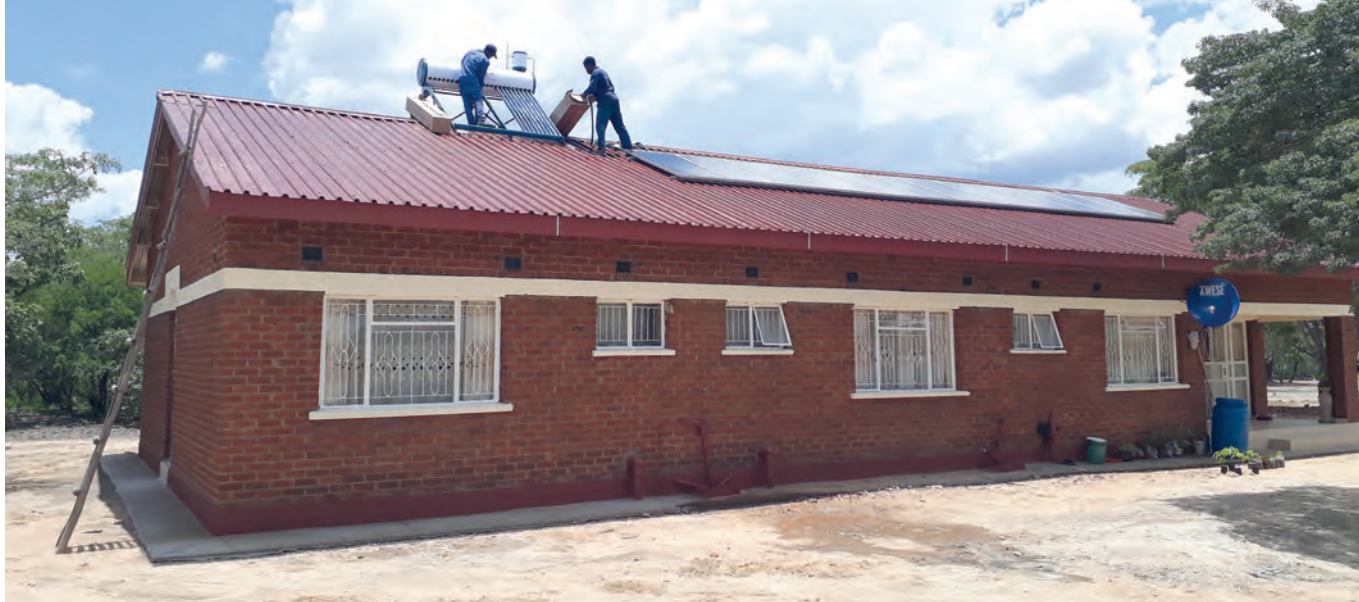
Těsně před Vánoci 2020 jsme ještě stihli zrealizovat projekty domácích slunečních elektráren a slunečního ohřívání vody; Foto: archiv OMI
