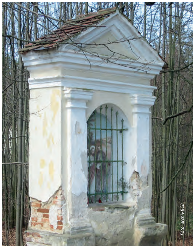
Kapličky jsou nyní ve velmi špatném stavu (5. zastavení – U smutné duše).
